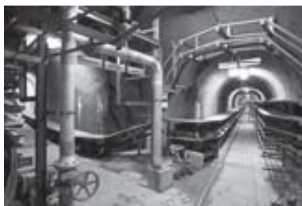
Primární kolektor „Tkalcovská“
